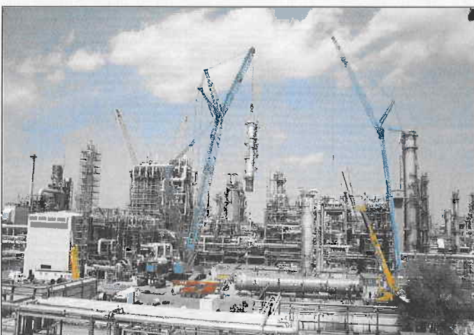
Abb. 6 Revamp der Ethylenanlage im Jahr 2005
